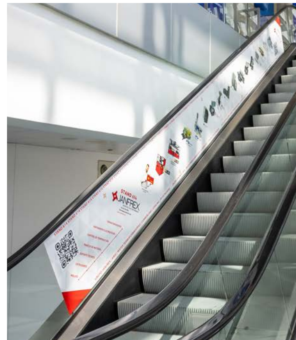
Escaleras eléctricas (Barandales)
